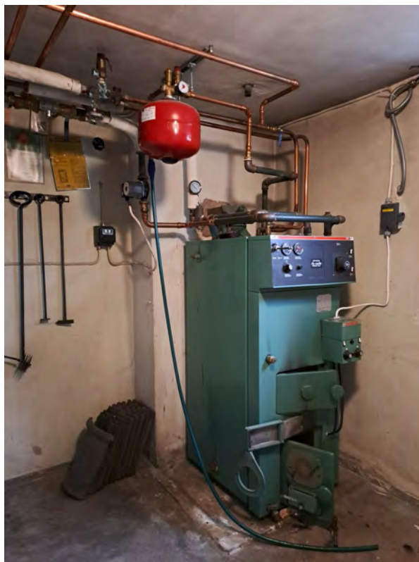
Pannrummet, gamla pannan fungerar
