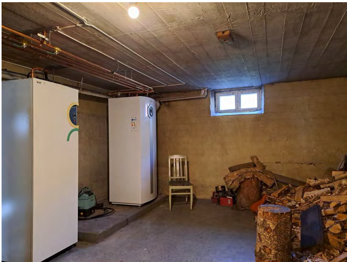
Pannrum, den borte anläggningen är den som används
